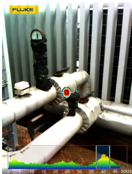
管道气体泄漏检测
